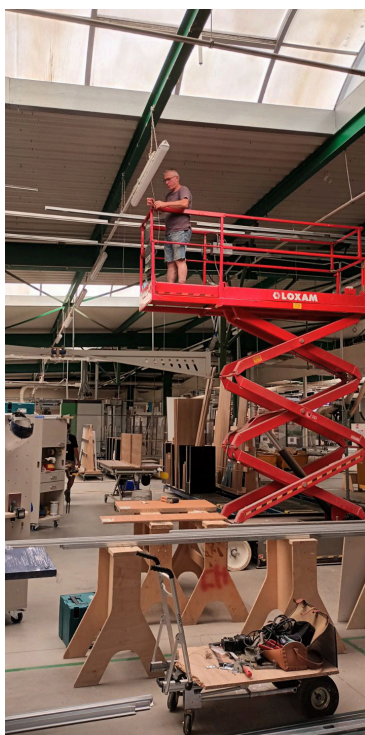
Pose des gaines textiles à XX m maximum. Conformément aux contraintes du bâtiment.
